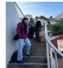
escaliers non conformes
