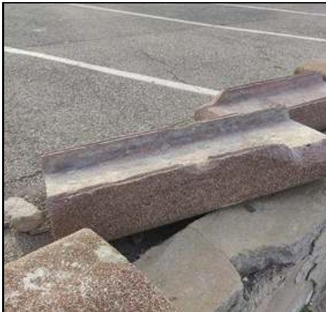
Eléments de dégradation à Escale Borély
